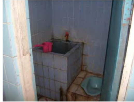
Gambar 3.2 Kondisi Dalam Toilet Siswa
