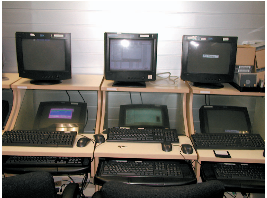
Salah satu sudut ruang server BSI yang menangani semua sistem di KTB.
